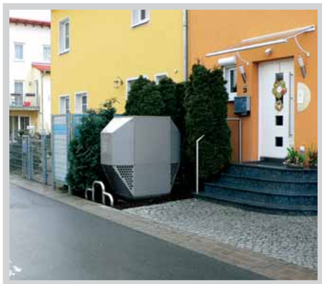
Venkovní část tepelného čerpadla. Foto: Karel Srdečný, EkoWATT
